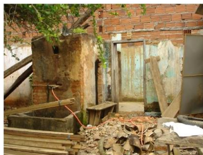
Foto 6: Área onde ficava o sanitário.
