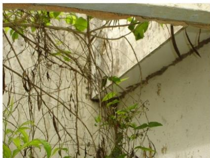
Foto 5: O local já não possui teto
