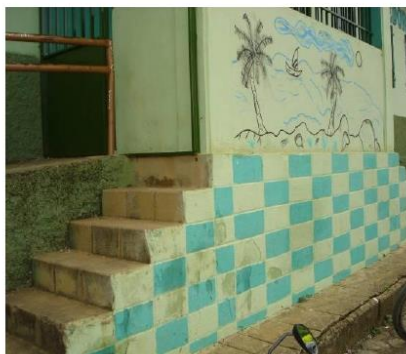
Foto 4: Detalhe do lado esquerdo, onde há uma rampa, que garante acessibilidade a todos
