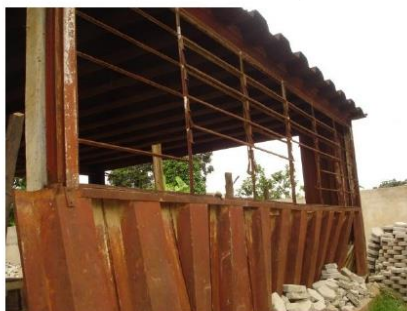
Foto 6: Restos da estrutura metálica e janelas do imóvel onde funcionava o Grupo Escolar João Pedro Ramalho
