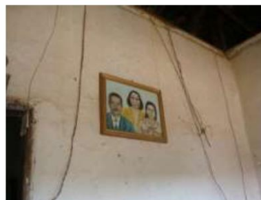
Paredes internas com sujidades e instalação elétrica irregular.
