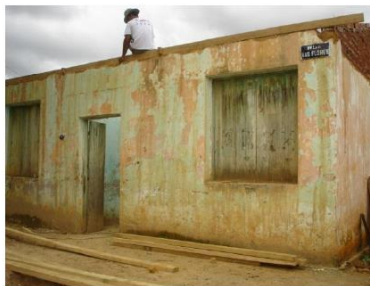
Foto 2: Funcionário da Prefeitura estava no local, que já não possui telhado
