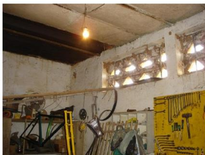
Foto 7: O que restou das paredes, agora funciona como local onde são guardadas ferramentas. Nota-se que ainda existe um pedaço do antigo forro no teto.
