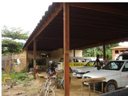
Foto 5: A estrutura metálica foi mantida para estacionamento de veículos da Prefeitura, mas no local havia paredes e funcionavam salas de aula.
