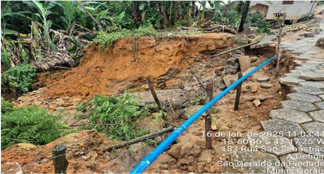
Foto 04 – Muro de contenção – Meta 04 após chuvas intensas muro que existia colapsou.
