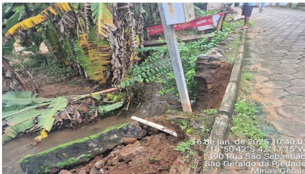
Foto 03 – Muro de contenção – Meta 03 após chuvas intensas muro que existia colapsou.
