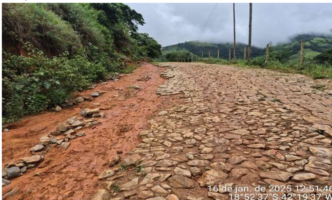
Foto 02– Pavimentação em blocos sextavados e drenagem – Meta 02 após chuvas intensas a pavimentação foi danificada.
