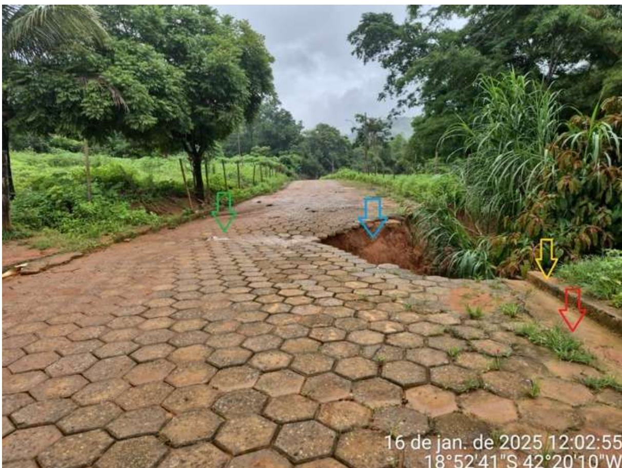
Foto 05 – Muro de contenção – Meta 05 após chuvas intensas muro que existia colapsou.
