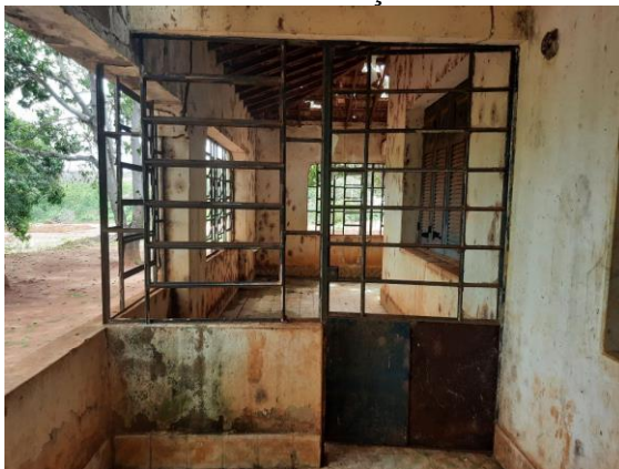
Foto 13 – Portão localizado no corredor externo. Data: 21/10/2021. Autor: Lister Lucas R. Gonçalves.
