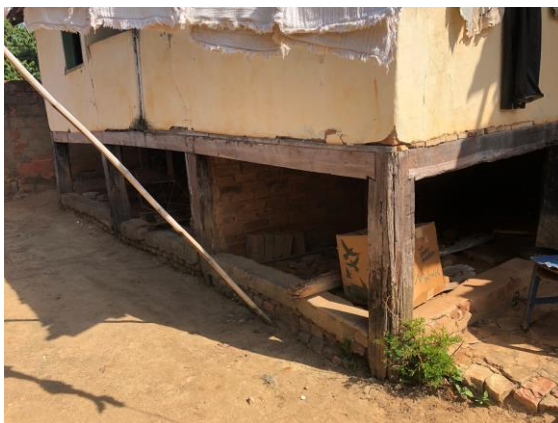
Foto 7 – Vão entre a residência e o solo.
