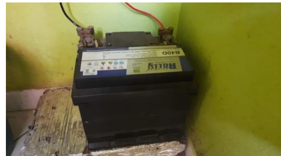
Foto 12 – Bateria utilizada como reserva para alguns equipamentos do estúdio.
