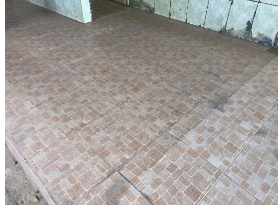
Foto 16 – Piso da área externa dos banheiros. Data: 20/08/2021. Autor: Lister Lucas R. Gonçalves.
