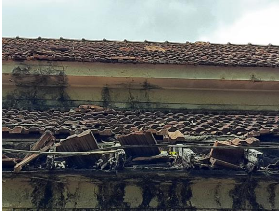
Foto 9 – Telhas danificadas. Data: 21/10/2021. Autor: Lister Lucas R. Gonçalves.
