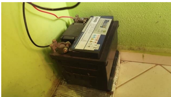
Foto 13 – Vista lateral da bateria.
