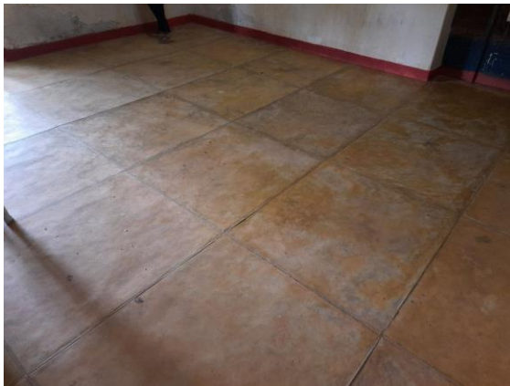
Foto 31 – Piso do salão aos fundos do bem. Data: 21/10/2021. Autor: Lister Lucas R. Gonçalves.
