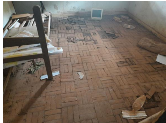
Foto 36 – Piso de um dos quartos que não estão sendo utilizados. Data: 21/10/2021. Autor: Lister Lucas R. Gonçalves.
