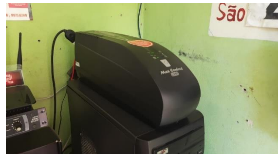
Foto 10 – Vista lateral esquerda do Nobreak.
