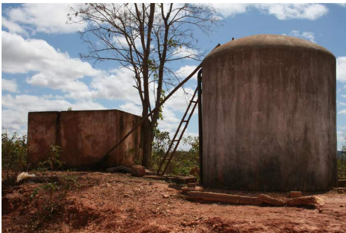
Figura 72 - Reservatório de Água que atende à Comunidade de Gentio (setembro de 2.014).
