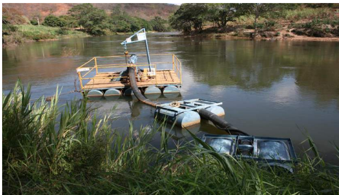
Figura 33 - Estação de captação de água da COPASA no rio Araçuaí – Município de Turmalina –MG (setembro de 2.014)
