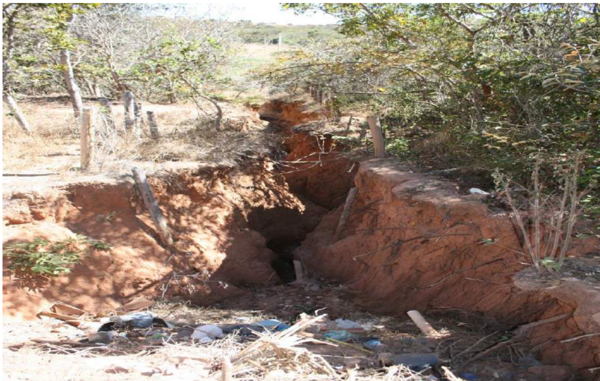
Figura 39 - Erosão na Escola Família (Zona urbana do Município de Turmalina) provocada por águas pluviais não drenadas provenientes do Bairro Nova Turmalina (setembro de 2.014)
