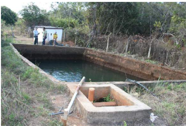
Figura 47 – Captação Secundária da Água em Caçaratiba (setembro de 2.014)
