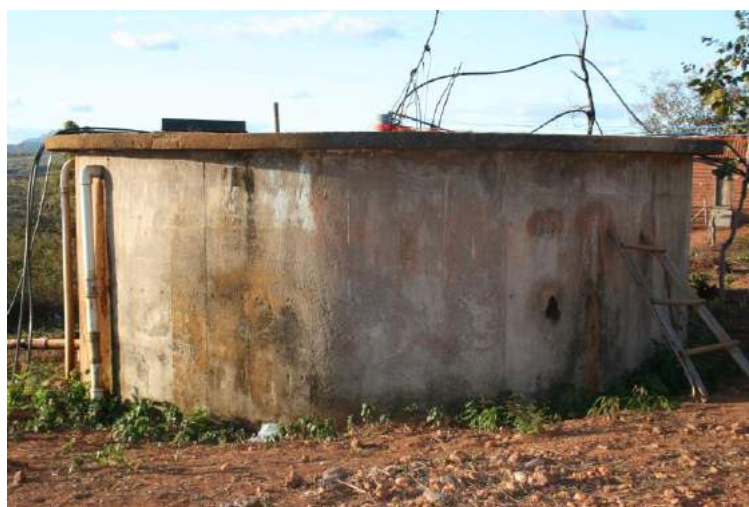
Figura 48 - Reservatório 2 Localizado na parte alta do Distrito de Caçaratiba (setembro de 2.014).
