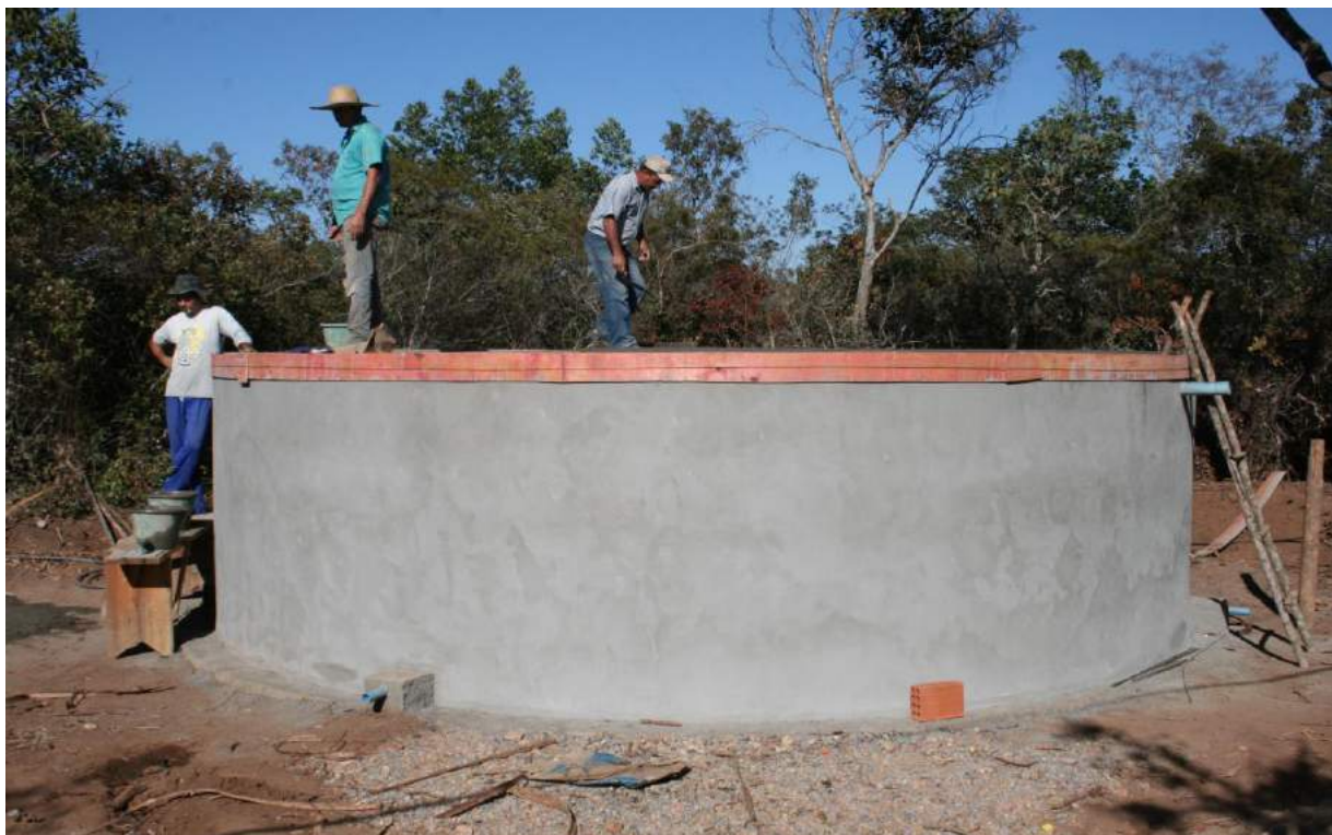
Figura 84 - Projeto Água do Lamba - Reservatório Trevo Veredinha - Capacidade 50 m 3 - Turmalina - MG
